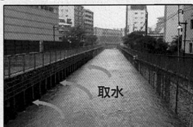
河川水位が上昇した際に取水
